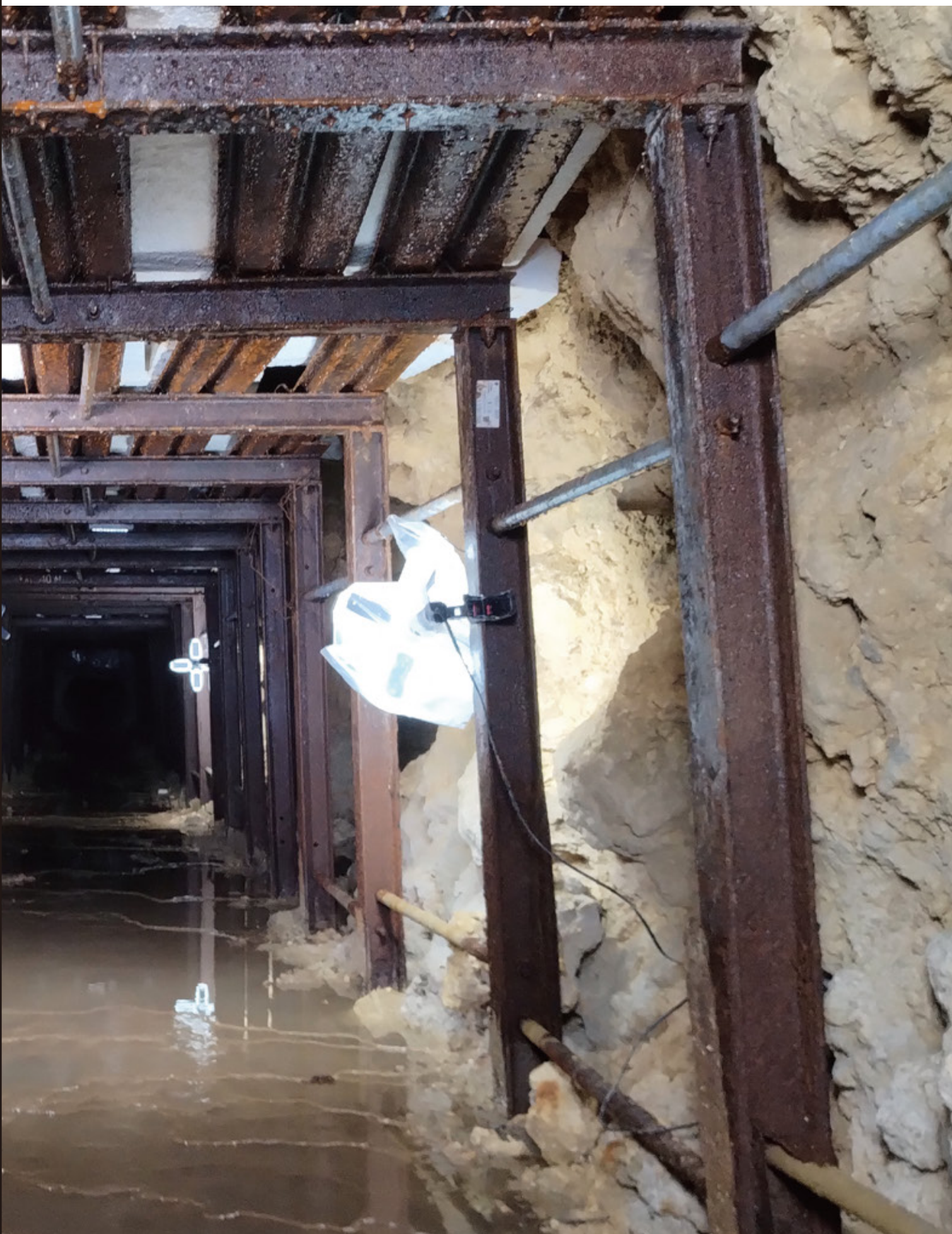
第5坑道内部の様子。絶えず水が染み出している。[2023年(令和5年)]
