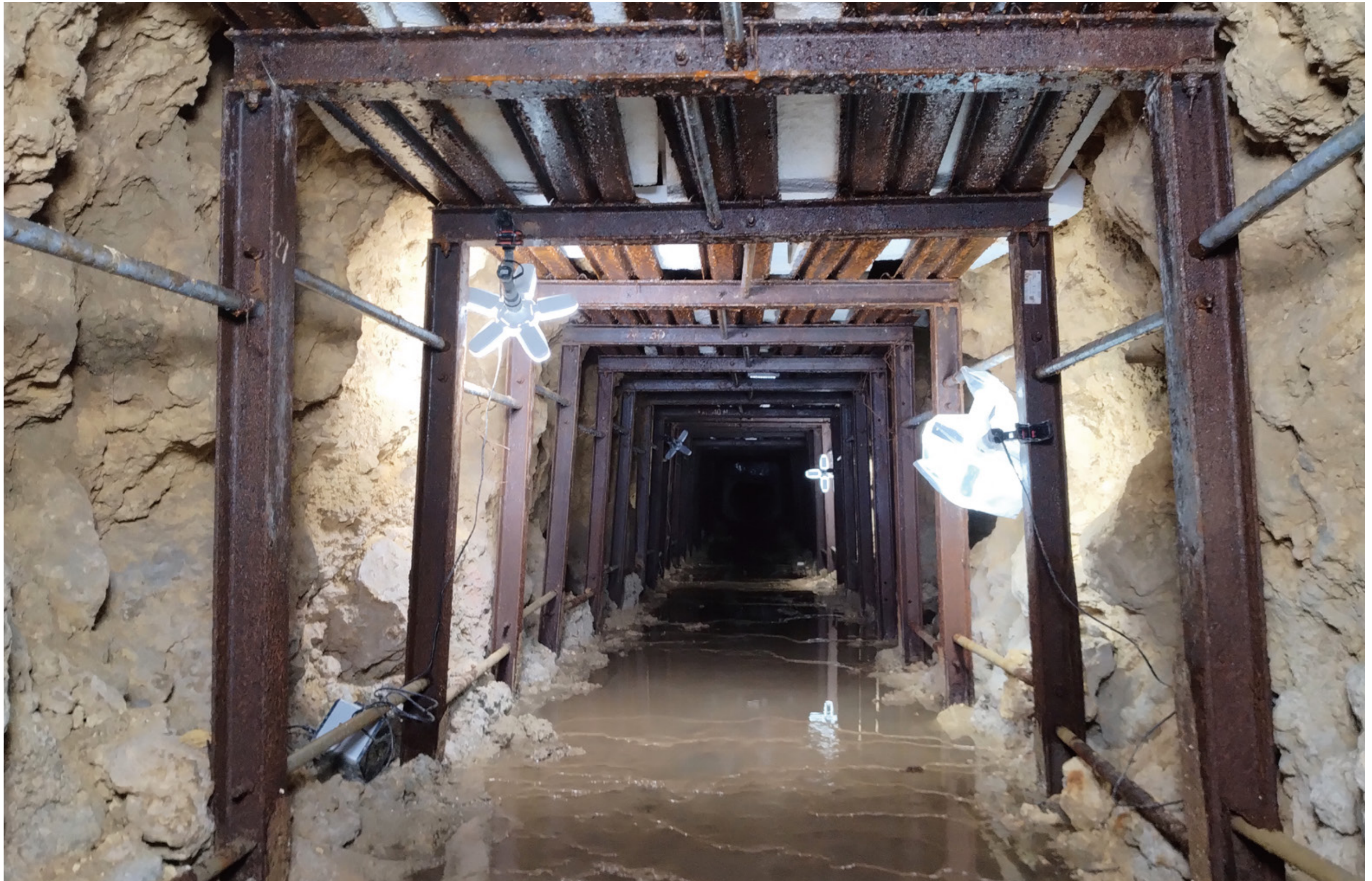
第5坑道内部の様子。絶えず水が染み出している。[2023年(令和5年)]
